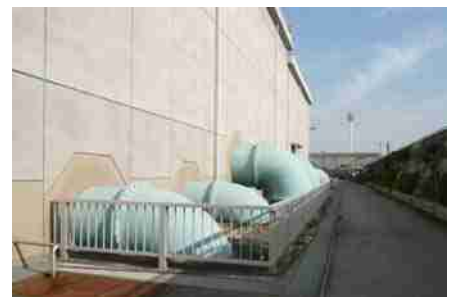
排水場 海への巨大排水管
