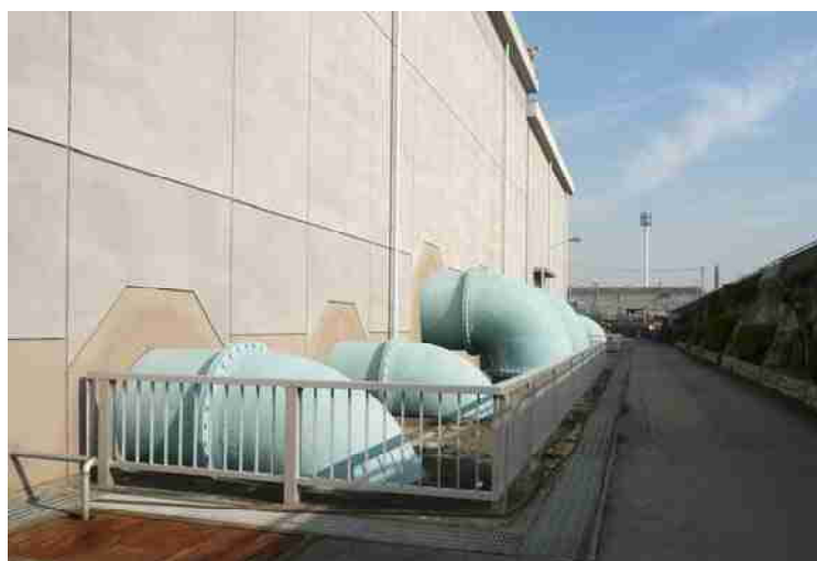
東浜排水場 の巨大排水管 5 基並んでいる
