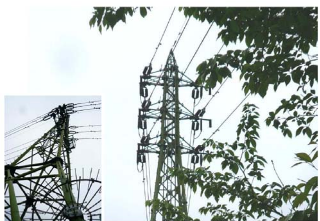
宇治川発電所の導水路と送電線が続く 三室戸寺界隈 2009.5.5.
