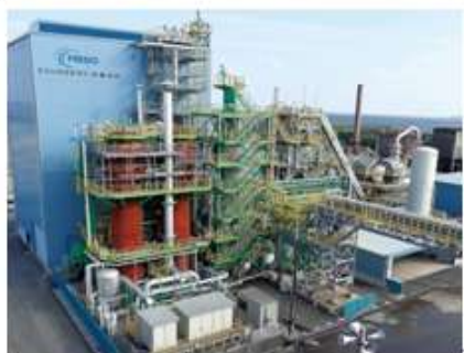
水素による還元とCO 2 の分離・回収によって、CO 2 の30%削減を目指すプロジェクトの試験高炉
