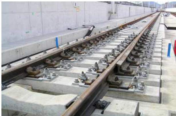
新幹線 ロングレールの開きがない継ぎ目
