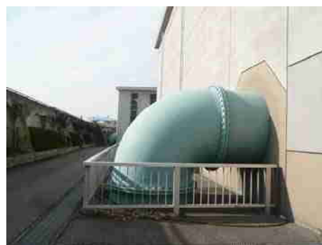
内港・河川の水を海へ排水する巨大配水管
