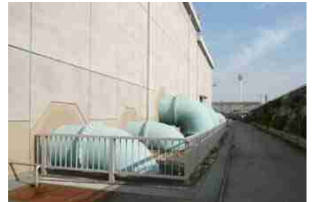
排水場 海への巨大排水管
